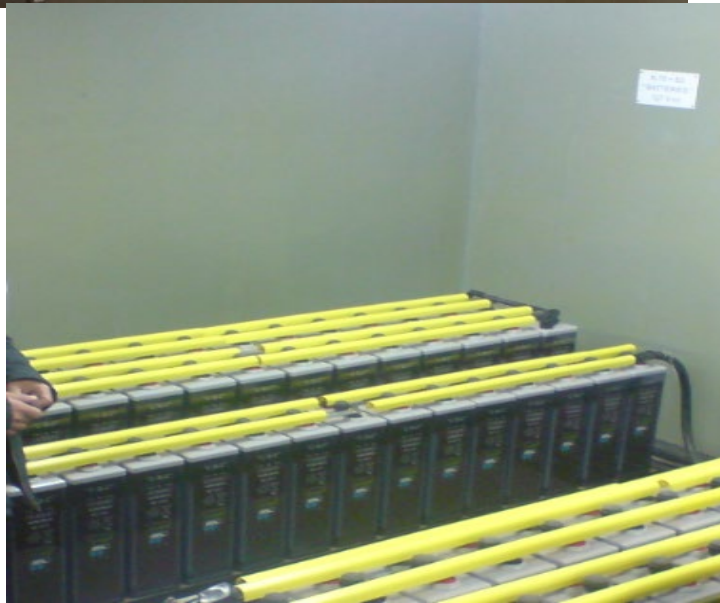
Poste Hassi Ameur , Oran 220/60 KV
